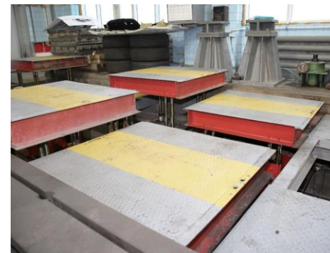
Электро-механические стойки (6 шт.)
